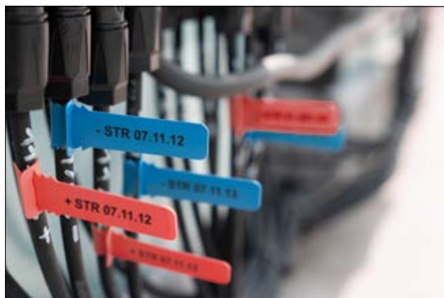
TAGPU LOOP - Identificazione dei cavi sull'inverter
