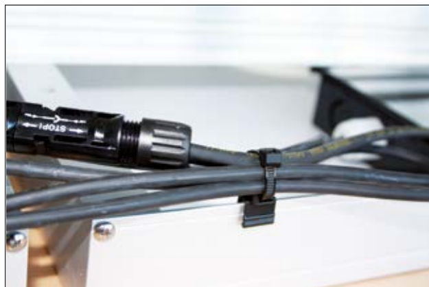
Facile organizzazione dei cavi a livello di modulo nella parte superiore di un bordo.
